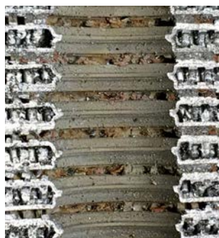
Canal de entrada con suciedad
