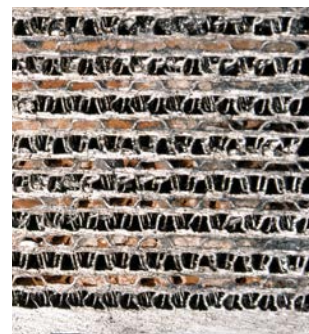
Láminas de refrigeración obstruidas
